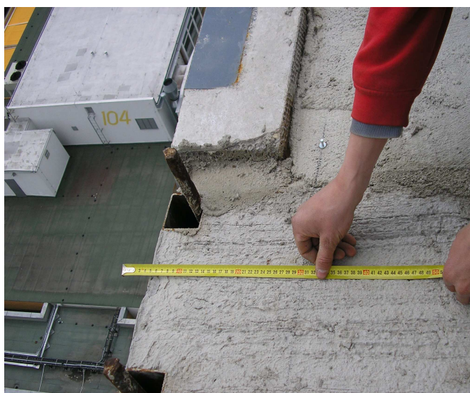
Obr.2 Výchylka sloupů ve vyšších patrech
