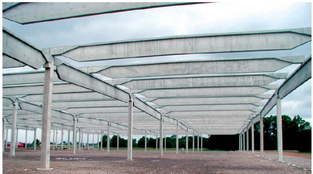
Fig. 1 General view of the precast hall structure Obr. 1 Celkový pohled na prefabrikovanou halu
